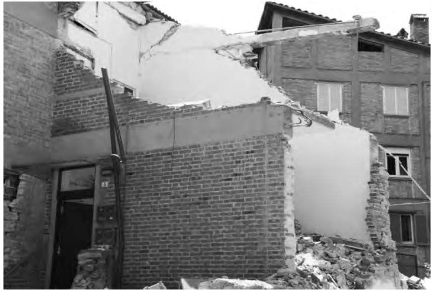
Figura 4.2 - Distacco e scivolamento di tetto a falde in c.a., con crollo della sottostante struttura (L'Aquila 2009)
