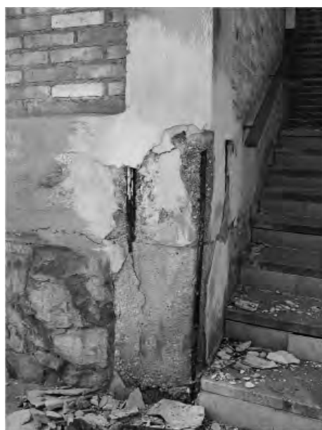
Figura 4.1 - Assenza di copriferro emersa a seguito di spicconatura di intonaco ad un pilastro in cemento armato
