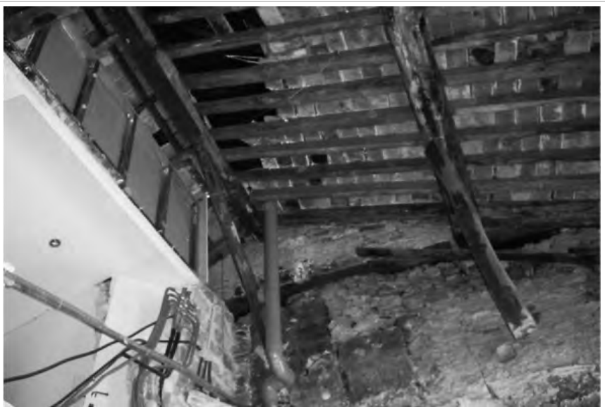
Figura 4.3 - Parziale crollo di copertura in legno fatiscente e spingente (L'Aquila 2009)
