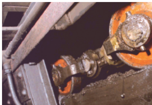
Accumulo di grasso e detriti nel carrello della scala mobile
