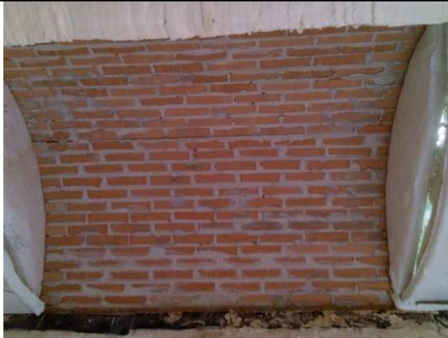
13/07/2015– figura 76 Vista volta all'intradosso (post prova). Si nota la lesione longitudinale in prossimità della sezione di mezzeria
