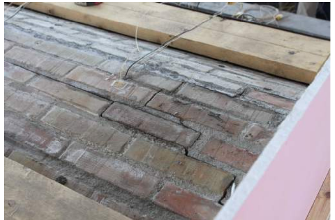
06/07/2015– figura 75 Esecuzione della prova (manifestazione di fessurazioni all'estradosso in corrispondenza della chiave)
