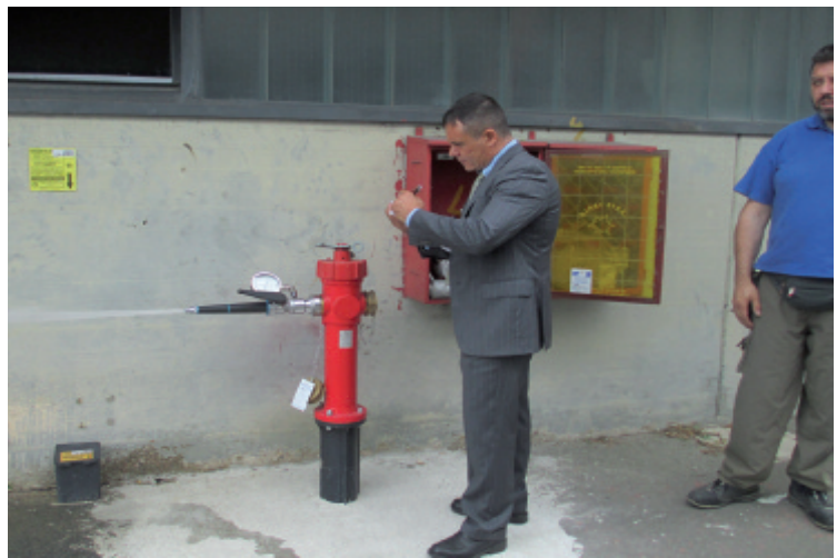
Il tecnico verificatore dell'associazione controlla l'operato del manutentore
