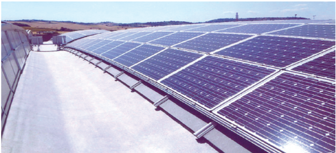
Figura 1 - Vista di copertura fotovoltaica
