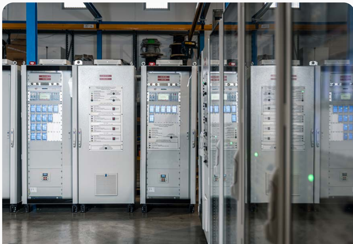
SV Sistemi di Sicurezza – Centrale EXFIRE360
