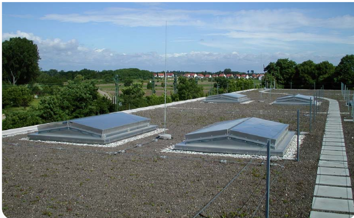
ENFC in copertura. Nella soluzione secondo Appendice G contano superficie utile, certificazione e governabilità del componente
