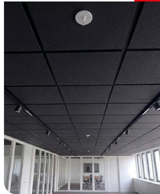
Installazione ugello Mini Nozzle in uffici
