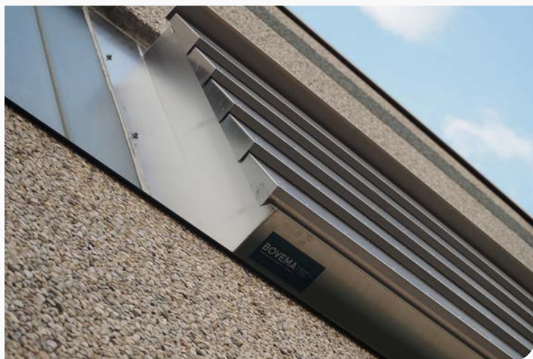
Dettaglio esterno di un evacuatore naturale di fumo e calore a lamelle. Le lamelle in alluminio, una volta azionate, si aprono fino a 90° per garantire la superficie utile richiesta
