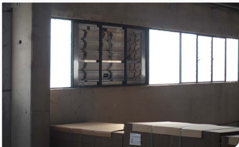
Interno del capannone con evacuatori a lamelle chiusi, installati nella parte alta della parete laterale. L'intervento ha riutilizzato le superfici vetrate esistenti per ospitare gli ENFC, limitando l'impatto sull'involucro edilizio e garantendo la distribuzione uniforme del sistema di smaltimento fumo
