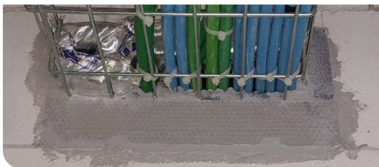
Attraversamento canalina portacavi su parete rigida
