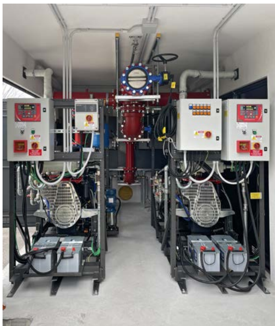
Veduta interna di un vano tecnico antincendio Fourgroup, con gruppo antincendio installato sottobattente, composto da due motopompe + jockey
