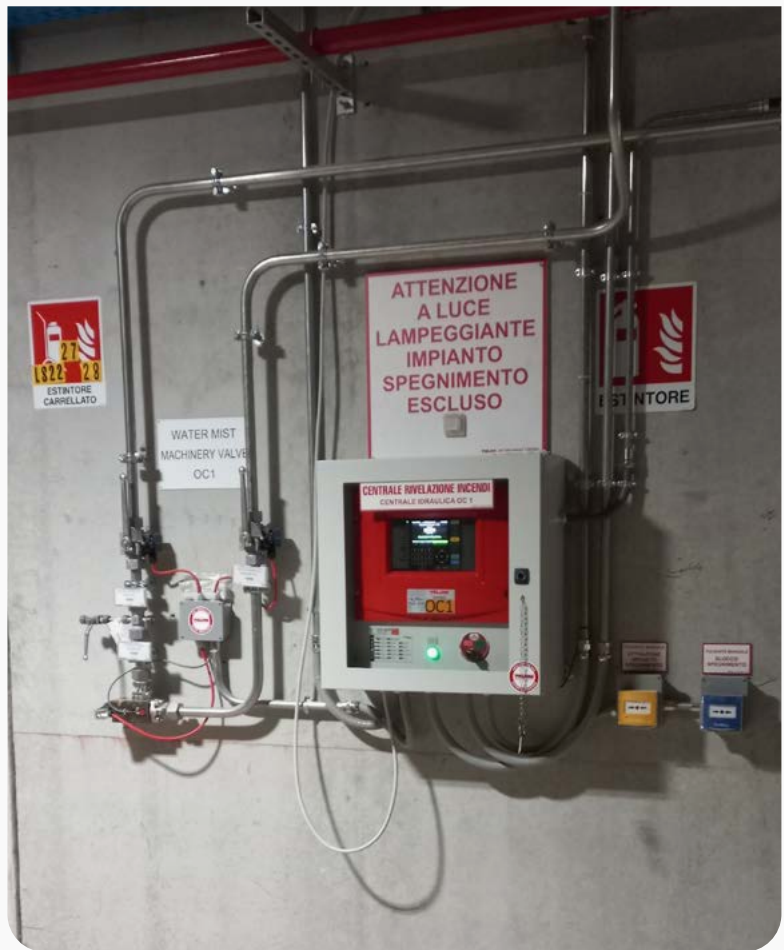
Figura 4 | Esempio installazione centrale di spegnimento a sorveglianza delle centrali idrauliche
