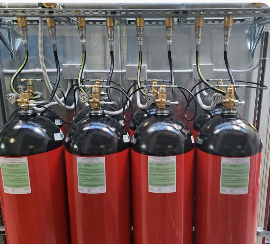
Figura 3 | Particolare della batteria bombole di azoto (IG-100) a 300 bar
