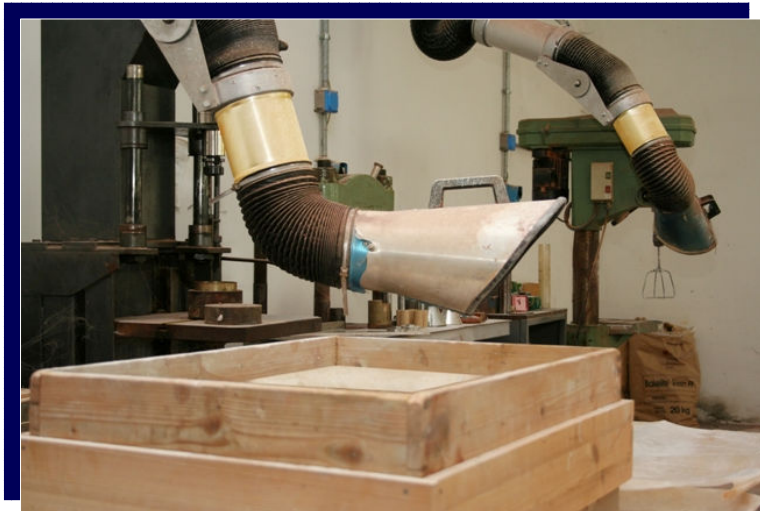
Locale miscele: macchinari aspirazione
